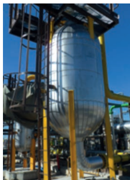
Figura 4.4.3.A. Ejemplo aislamiento en equipo vertical.
