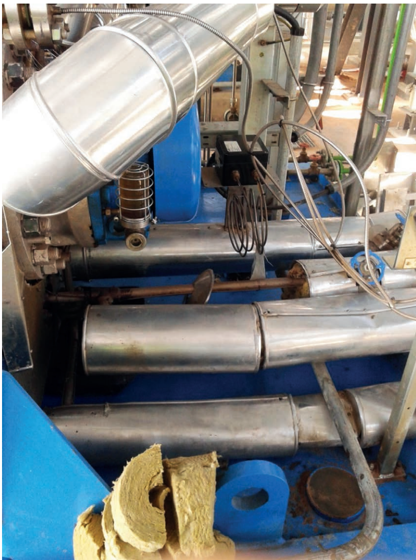
Figura 4.12.2.B. Ejemplo de aislamiento dañado en planta.
